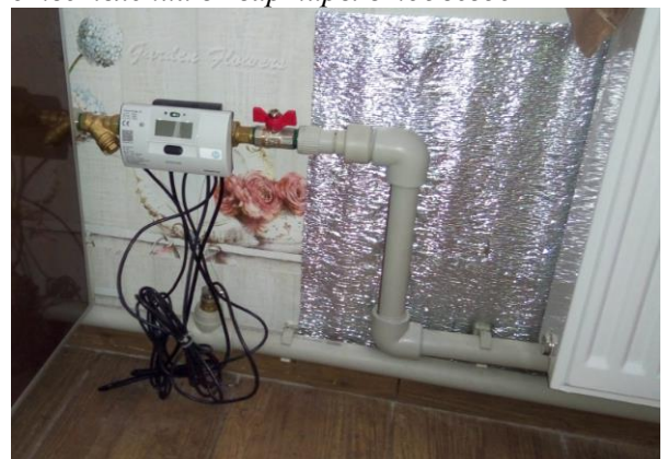
Рис. 3. Фрагмент установки квартирного счетчика тепла
