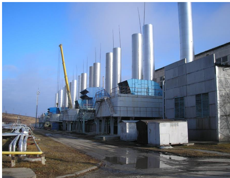
Рис. 1. Димові труби висотою 22 м компресорної станції «Задніпровська» магістрального газопроводу «Кременчук – Ананьїв – Чернівці – Богородчани»
