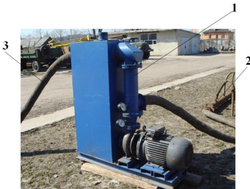
Рис. 1. Загальний вигляд установки ПУВВ-5МЕА: 1 - приводна станція; 2 - лінійна всмоктувальна система з іглофільтрами; 3 - зливна лінія.
