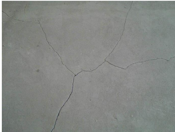
Рис. 1. Температурні тріщини на поверхні бетону
